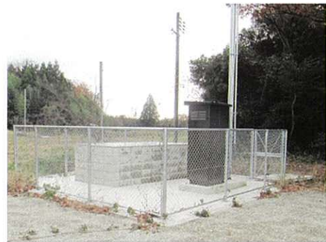
揚水機施設（過年度設置分）
