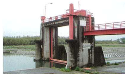
重要水防構造物（頭首工） 集中豪雨等の災害時には、早急に防災 対応が出来る体制を整備
