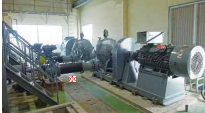
主ポンプ及び原動機設備：更新 「※」：本管は後日搬入される「逆止弁」と入れ替わる。
